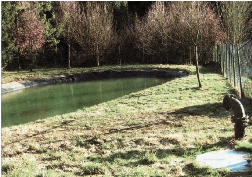
Rybník na požární vodu s odběrným zařízením
