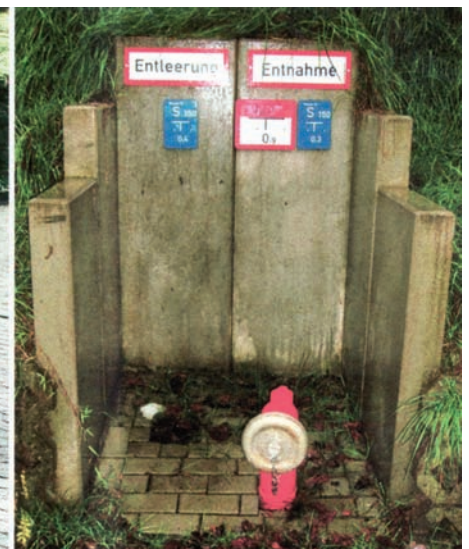
Odběrné zařízení u nádrže na požární vodu (prázdnění, odběr)
