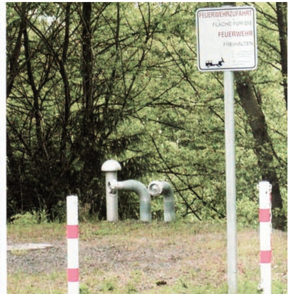
Nádrž na vodu pro hašení – označení odběrného místa
