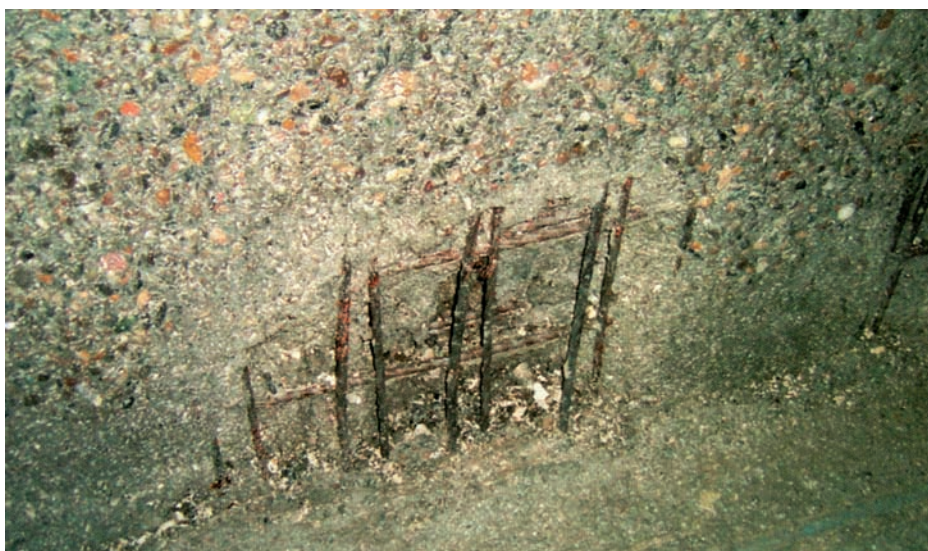
Obr. 2: Pórovitý povrch stěn byl místy odstraněn až do hloubky 5–10 mm. Zčásti byla vidět i pod ním ležící výztuž
