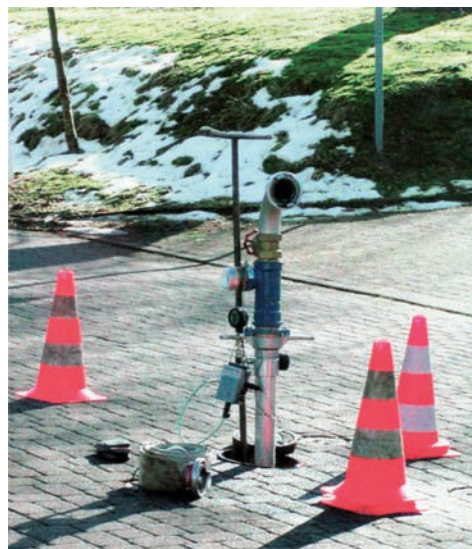
Měření spotřeby požární vody
