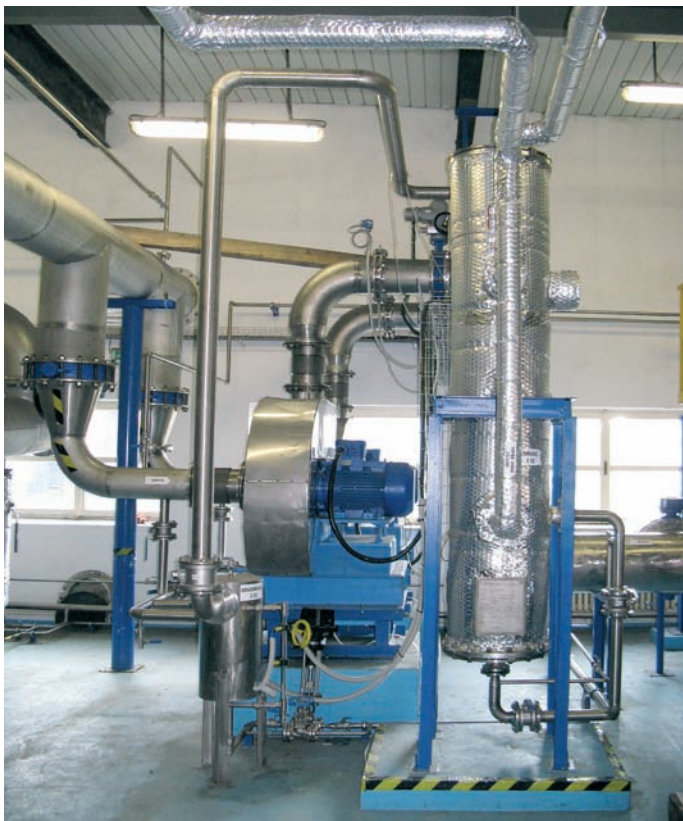
Obr. 3: Objekt stanice pro čištění bioplynu – další pohled na uspořádání technologie
