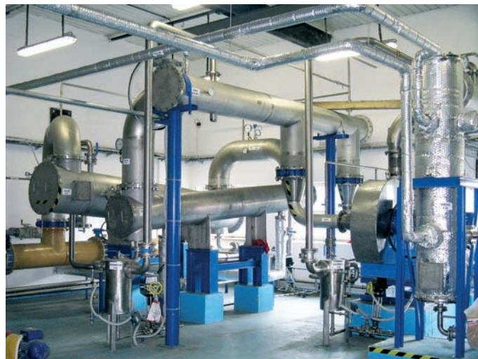
Obr. 2: Objekt stanice pro čištění bioplynu – pohled na uspořádání technologie
