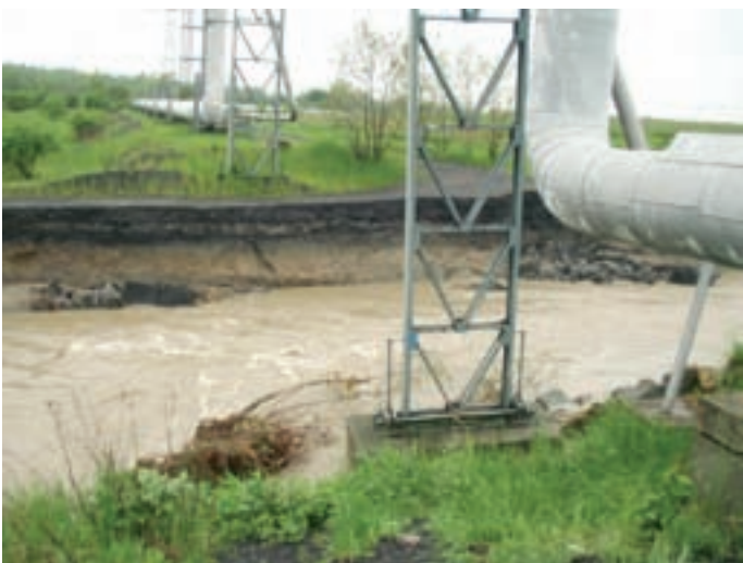
Přemostění Mlýnky – havarovaná stojina OK
