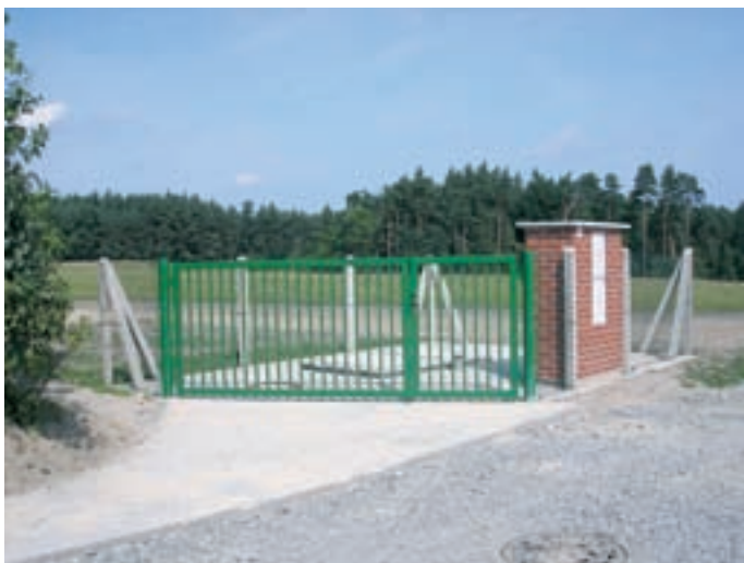
Bělá pod Bezdězem, čerpací stanice odpadních vod
