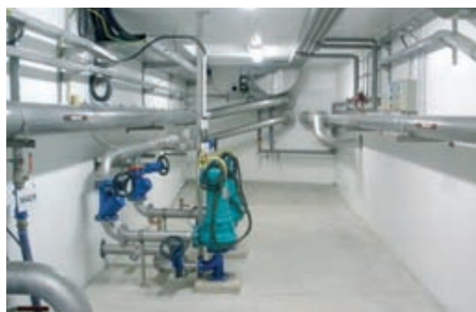
ČOV I Mladá Boleslav-Neuberk, interiér kolektoru objektu odvodnění kalu
