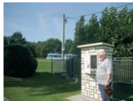
Obr. 6: Automaticky řízená zesílená drenáž v Ostravě-Třebovicích dnes. Vybudovaná v roce 1974. Při první rekonstrukci v roce 1994 byla vybavena zařízením MIRISAT
